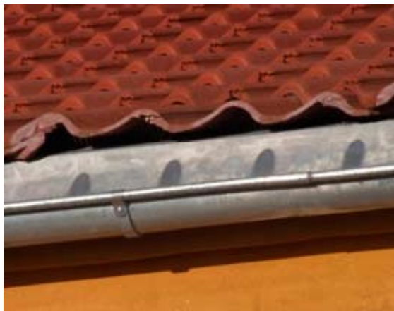
Billede: Dryp fra betontagsten
